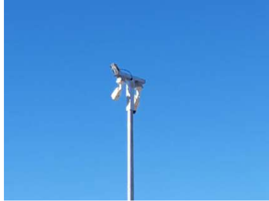
Fig. 3 Detalle de parte superior de cámara de vigilancia
